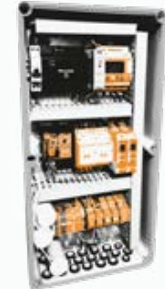
Armoire de Commande
